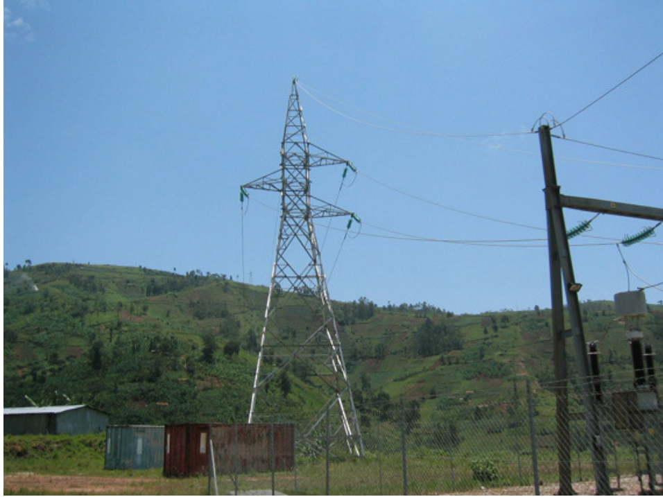
Départ Ligne 110 kV – Poste Rwegura
